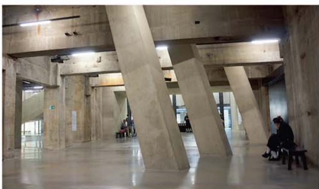
泰特二期建築全場最讓人驚喜的，也許是打斜落到地下室，暴露在外的清水混凝土結構。它與老發電廠的舊牆、油箱，兩個世紀的建築骨幹在此相處一室，形成一個簡練空間
